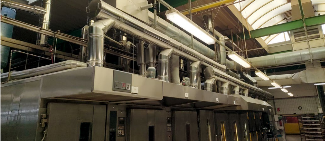
Solche Wärmerückgewinnungsanlagen zählen zu den sinnvollen Energieeffizienzmaßnahmen
