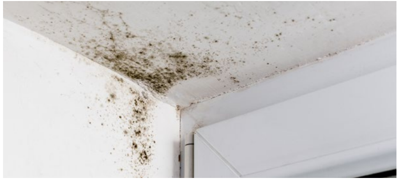
Wo eine hohe Luftfeuchtigkeit herrscht, kann sich schnell an Wänden Schimmel bilden
