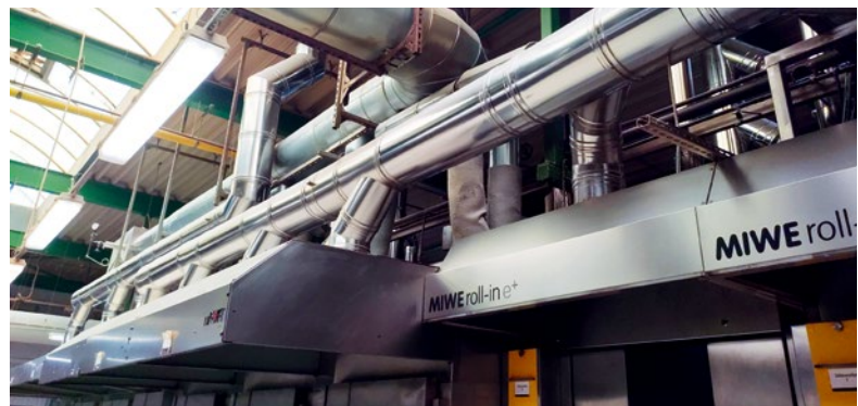
Ein Abluftsystem sorgt für ein gutes Raumklima und reduziert die Belastungen in der Luft
