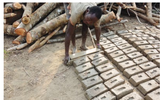
Das Internat wird aus Ziegelsteinen gebaut, die in Handarbeit hergestellt werden. Für gute, stabile Ziegel braucht es von Termitenhügeln durchsetzte Erde. Der Lehm Boden wird mit Wasser angerührt, in Ziegelform gepresst und bis zu 48 Stunden gebrannt
