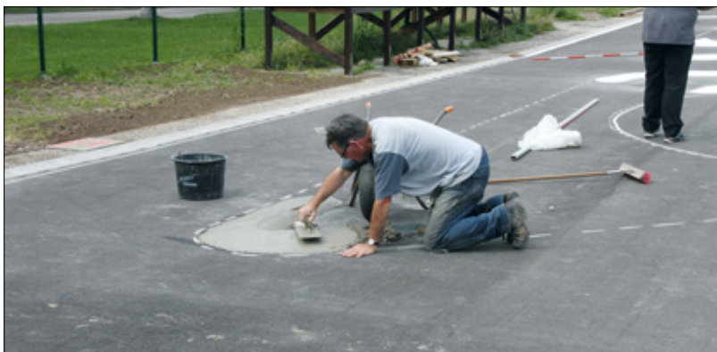
Johannes Tomke war für den Bau der Curbs zuständig. Das war eine aufwändige Arbeit
