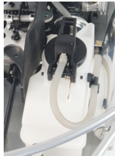
Der Tank entspricht den üblichen Standards. Die Leitungen sind sauber verlegt, könnten aber etwas länger sein
