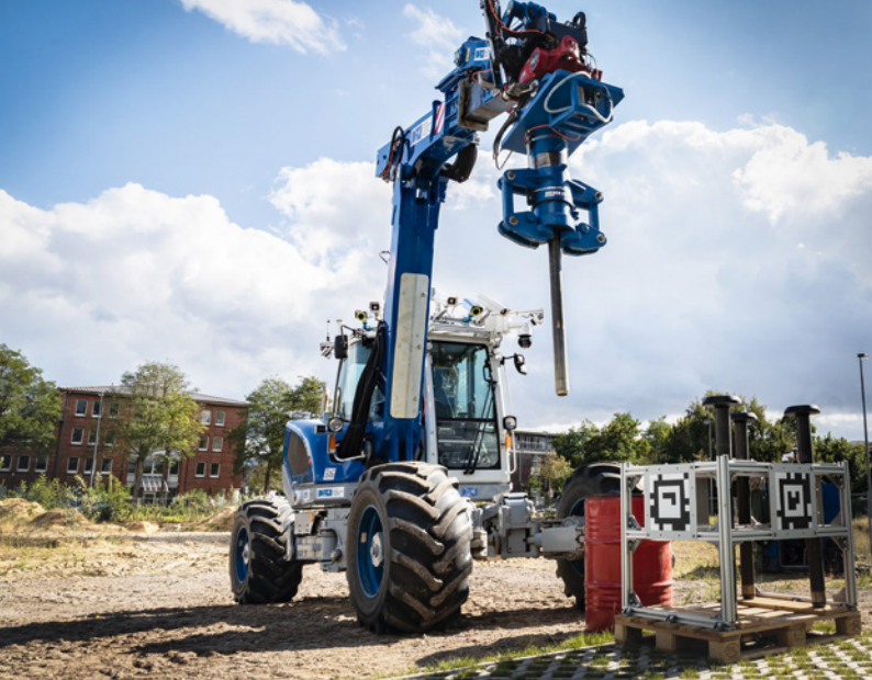
Einen 12 Tonnen schweren Menzi Muck M545-Schreitbagger stattete man beim DFKI mit ordentlich Kamera-Power aus
