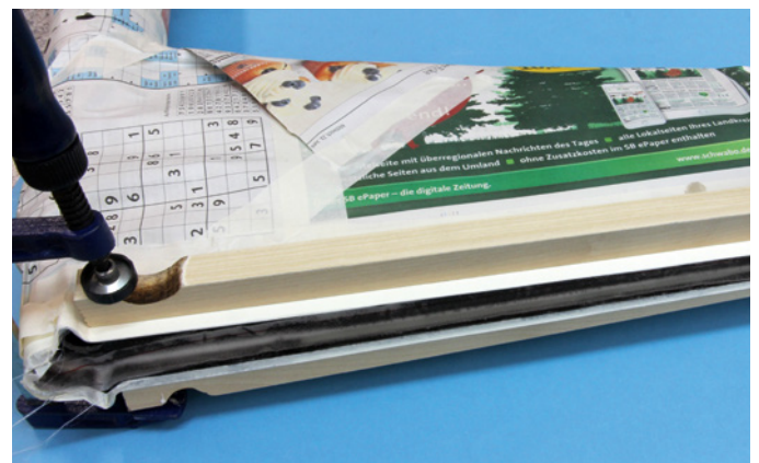
Die Seitenrunderabschlussleiste wird während der Verklebung mit zwei Schraubzwingen und langen Hartholzleisten in Position gehalten. Auch hier kommt ein Gewebekband zum Einsatz, um den Übergang vom Rumpf zum Spant zu verstärken
