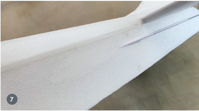
Hier muss man schon gut hinschauen: der Durchführungsspalt ist weg
