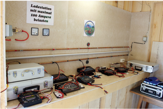
An so einer Stromversorgung lassen sich viele Ladegeräte gleichzeitig betreiben
