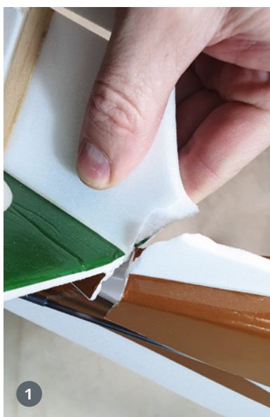
1) Für eine Bestandsaufnahme ist es wichtig, alle Problemstellen schonungslos aufzudecken
