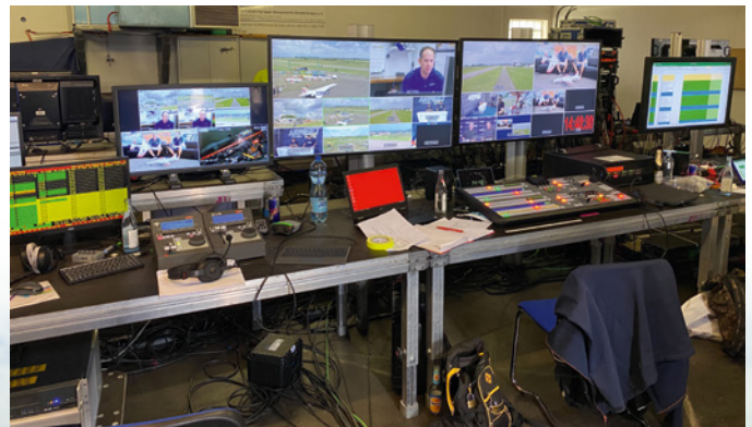
Im Hangar des Flugplatzes hatte Eventdienstleister WBLT eine beeindruckend Kommandozentrale für Regie und Online-Streaming aufgebaut
