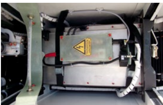
Einer von zwei brandfest verschlossenen Batteriekästen. Hier der mit 48 LiPo-Zellen im Motorraum. Darüber ist das Batteriemanagementsystem platziert
