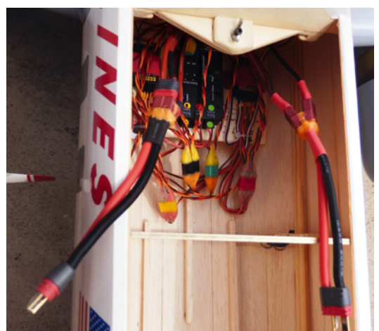
Die Verkabelung wird erst nach der Tragflächenmontage über den Wartungsdeckel verbunden. Die Y-Kabel mit den T-Steckern werden jeweils an einen Akku angesteckt
