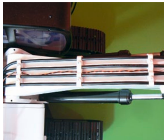
Die Abstandshalter halten die Hydraulikleitungen in Position und sichern diese vor dem Verdrehen
