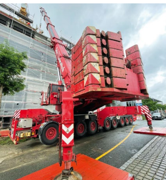
Am hinteren Ende des drehbaren Kranaufbaus sind Ballastplatten angebracht, dieses Gegengewicht kann an die erforderliche Traglast angepasst werden
