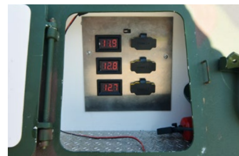
Drei XT-Stecker sind an der Seitenwand gut erreichbar
