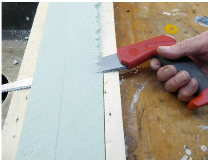
Zum Aufdoppeln eignet sich feinporiges Styrodur, das sich sehr gut verarbeiten lässt
