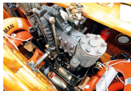
Direkt dahinter befindet sich die dampfbetriebene Rudermaschine
