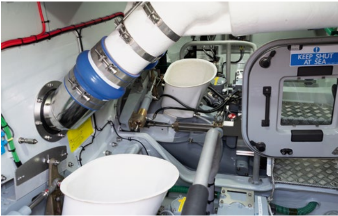
Im Maschinenraum befinden sich über dem Zulauf der Impeller Zugangsöffnungen
