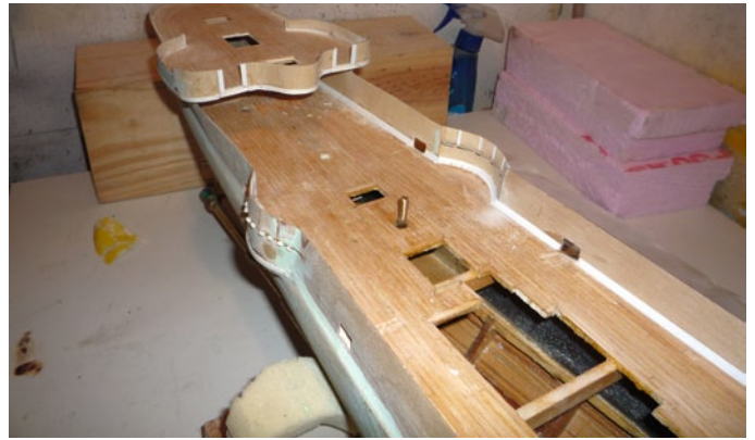
Das Achterdeck im Rohbau. Gut zu erkennen ist die Verwendung von sehr dünnem, jedoch stabilen und gut biegsamen Sperrholz für die Schanz
