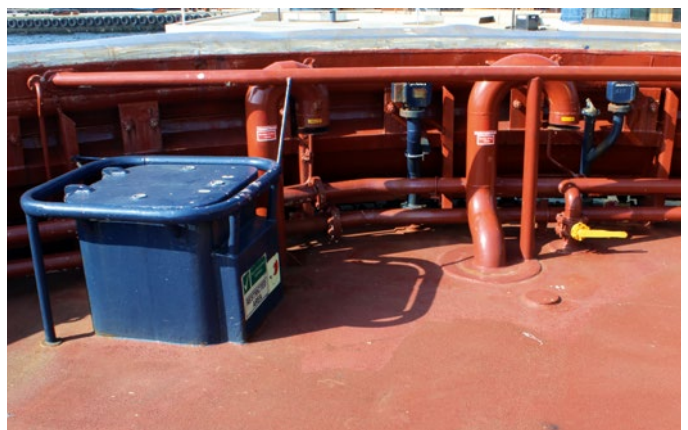
Viele der Rohrleitungen, die bei anderen Schleppern innen verlegt sind, verlaufen bei der SVITZER TRYM außen
