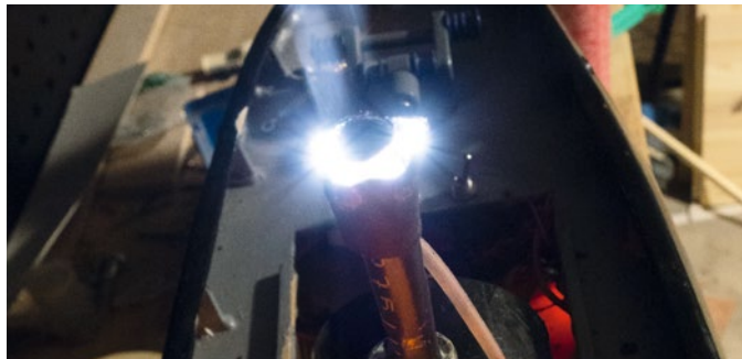
Auch die LEDs am Schornstein mussten noch einmal ausgetauscht werden
