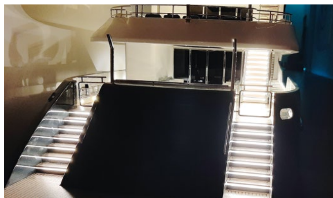
Die Treppenstufenbeleuchtungen bestehen aus 2-mm-LED-Stripes und Lichtleitern
