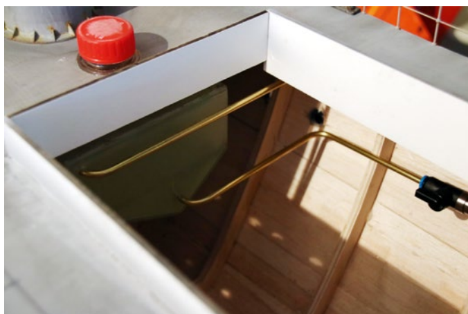
Die Messingleitungen müssen vom Bug nach mittschiffs zum Dampfgenerator geführt werden – der Absperrhahn muss sein
