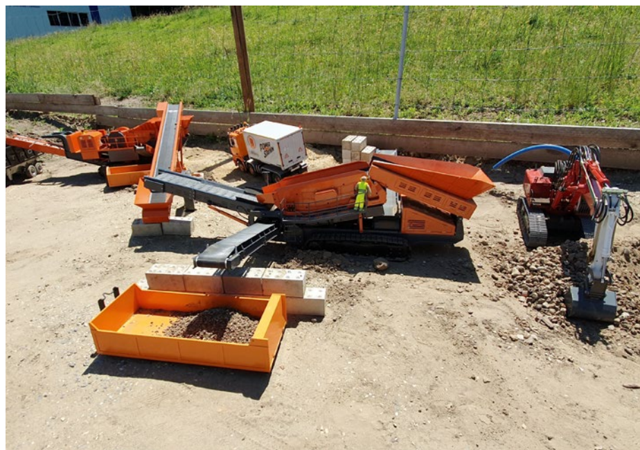
Mobile Siebanlage diesen Sommer im Einsatz
