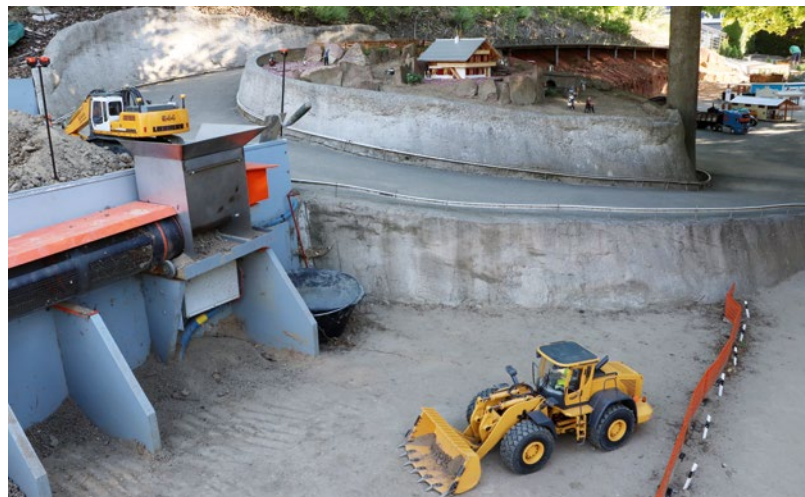
Eine stationäre Siebanlage (links) ist ebenfalls Teil der Anlage und wird fleißig genutzt. Im Hintergrund: die Auffahrt zur Metallbrücke
