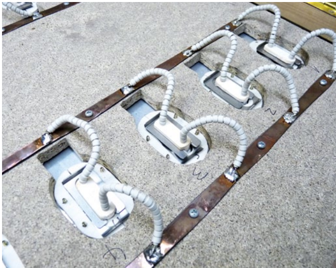
Elektrisch werden alle Heizstrahler schlicht parallel geschaltet, was den Verkabelungsaufwand und die Verlegung der Stromleiter stark vereinfachte. Die Leiter sind aus 0,5 mm dickem Kupfer geschnitten und in der Breite für die Belastung dimensioniert
