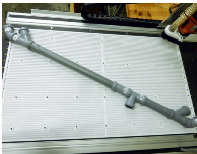
Hier ist sie schon an der Maschine verschraubt und die HT-Rohre für die Absaugung sind vorbereitet
